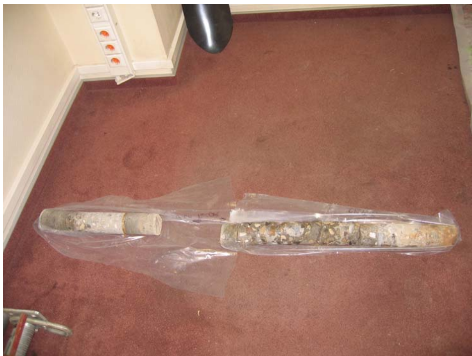
Фото 19. Вид керна, извлеченного из скважины-вскрытия СА-6. Разрыв между частями керна указывает на наличие песчаной подготовки мощностью 0,32м.
