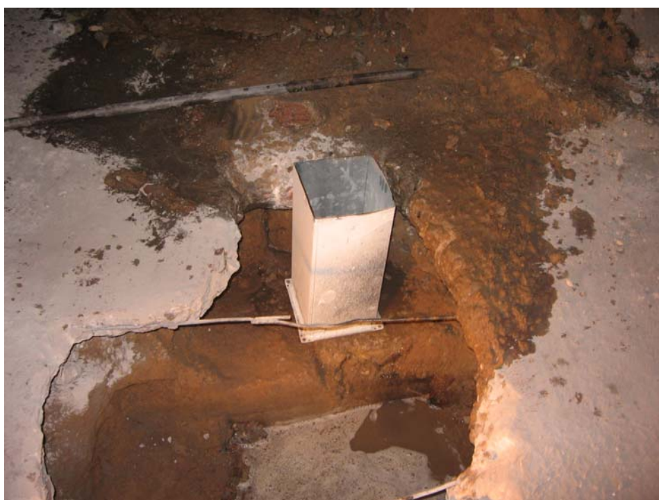
Фото 10. Фундаментная лента в шурфе № 3. Уровень воды h = 0,57 м.
